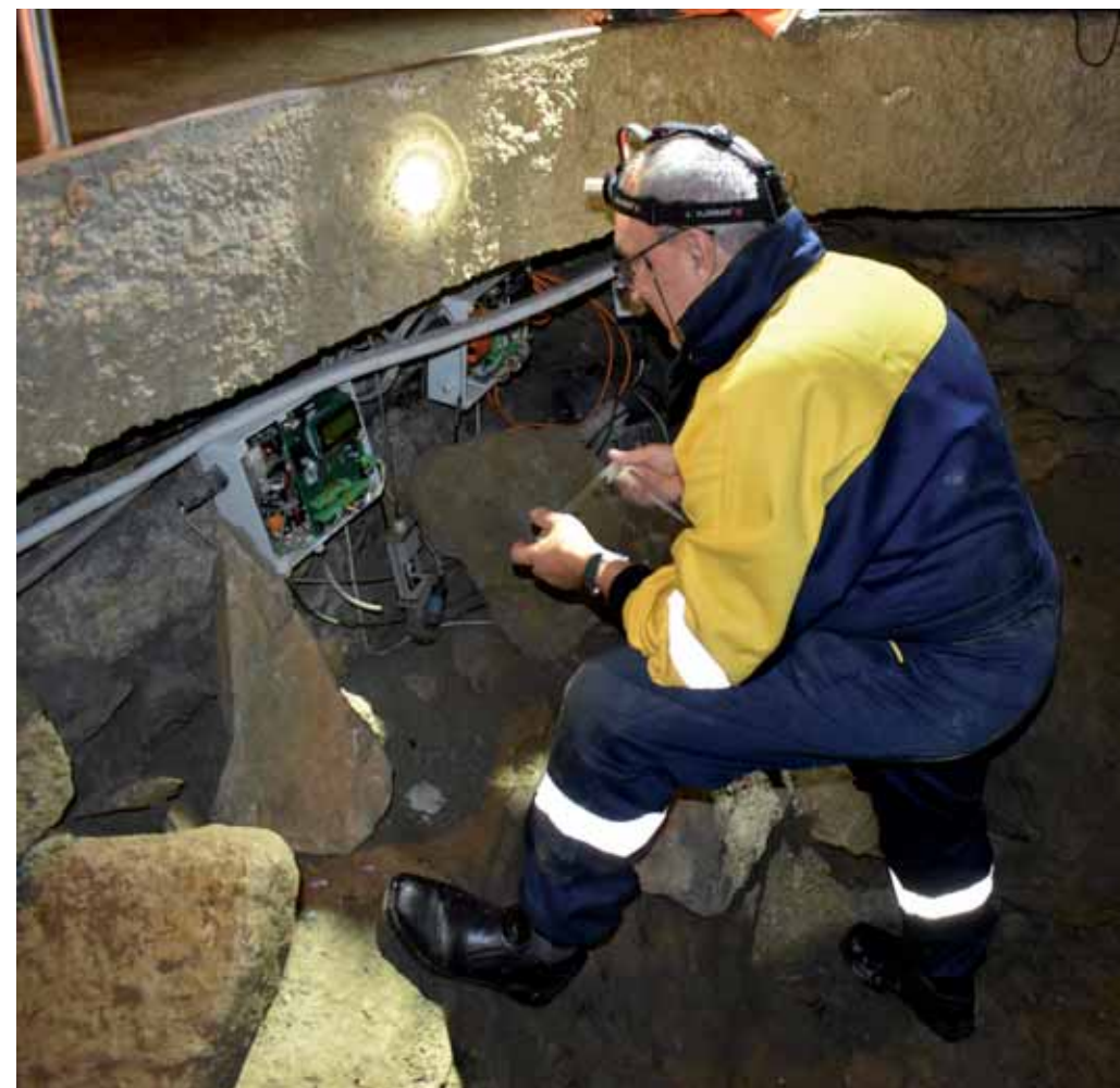
Revize řídicích jednotek monitoringu mikroklimatu v Jurikově dómě. Foto Slavomír Černý
